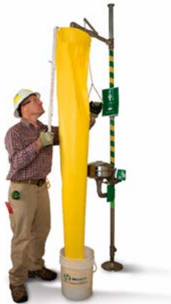
Fot. 4. Przykładowy zestaw do testowania urządzeń awaryjnych
